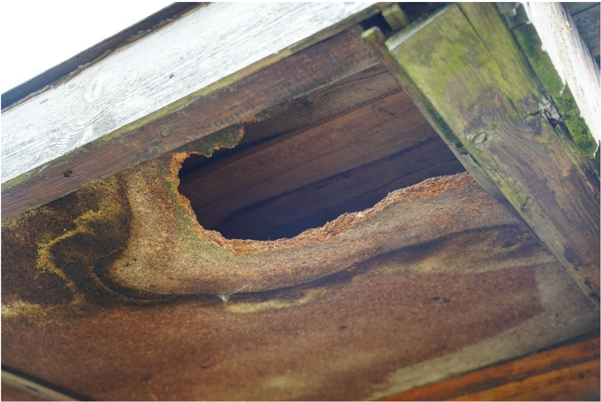
Abbildung 13: Loch auf der Unterseite des Daches
